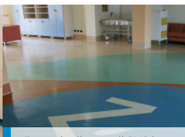
Esempio di posa di PVC in ambienti di lunga degenza - Casa di Riposo San Martino - Italia
