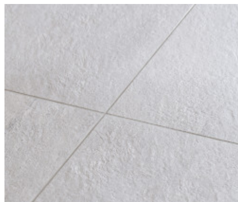
Pavimentazione stuccata con Keracolor GG
