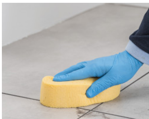
Rimozione con spugna dei residui di Flexcolor 4 LVT dalla superficie delle piastre
